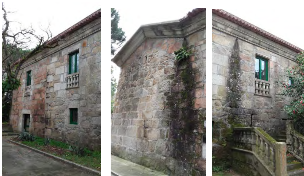
FACHADA CON NECESIDADE DE LIMPEZA.
