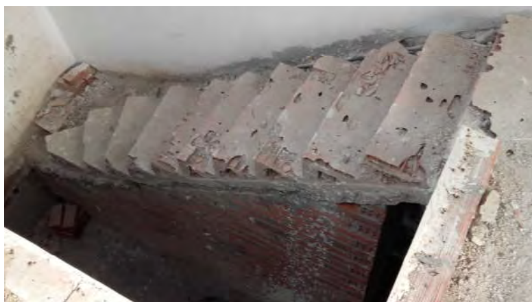
ESTADO ACTUAL DA ESCALEIRA ACCESO A PLT BAIXOCUBERTA
